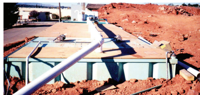
Protegida por la tierra, esta planta ADDIGEST® se encuentra semi-enterrada como se ilustra en esta fotografía.
